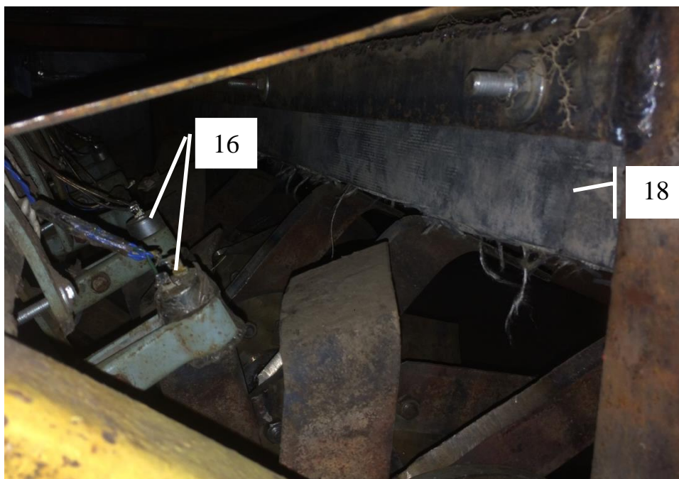
Рисунок 5.5 - Датчики Холла и отбойник смонтированные над барабаном фрезы
