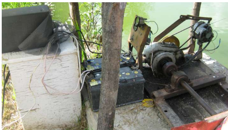
Рис. 2. Общий вид энергетического блока микроГЭС.
