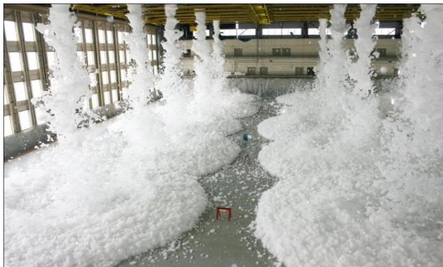
Рис. 4. Спринклерная установка пожаротушения.
